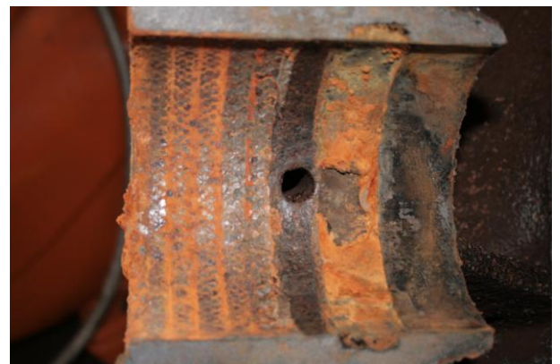
Abb. 12: Verschleiß im Bereich der Stopfbuchspackung am Pumpendeckel
