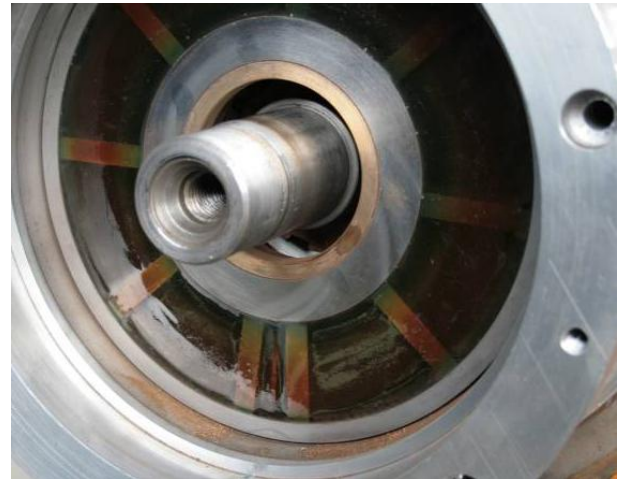
Abb. 11: Anlaufring im Axialmagnetlager mit Abrieb
