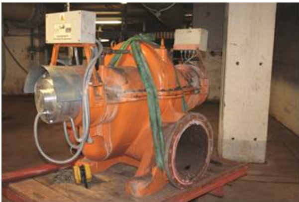
Abb. 2: Magnetgelagerte Pumpe nach dem Langzeiteinsatz aus der Anlage ausgebaut
