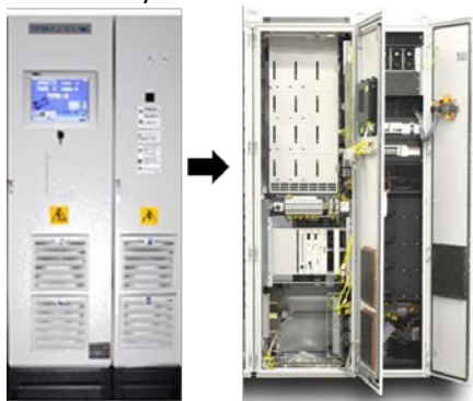
Figure 6: Standard AMB control cabinet
