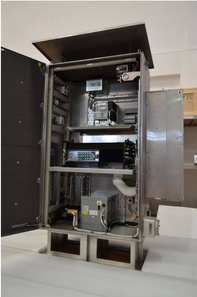
Figure 10. AMB controller enclosure with front door open.
