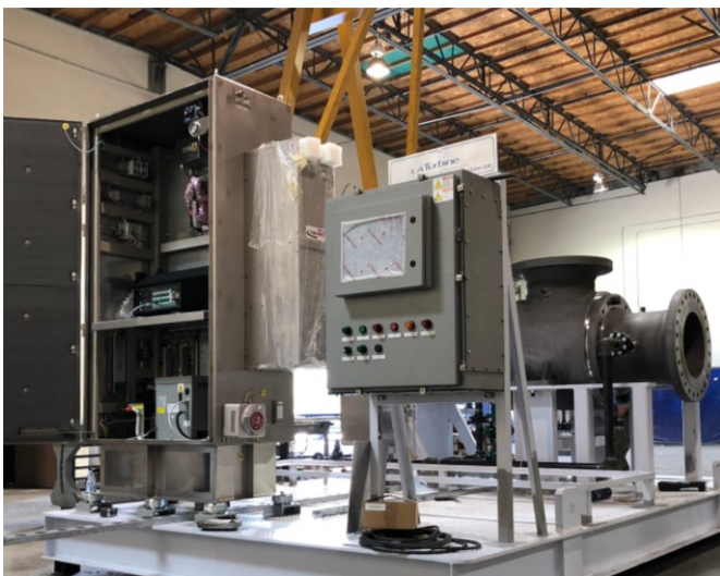
Figure 11. AMB controller enclosure mounted to the skid.
