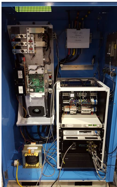
Fig. 11: Turbo-aerator motor and AMB power electronics cabinet.
